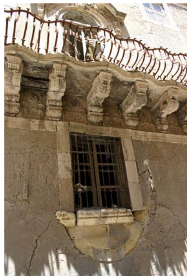
Fig. 5. Distacco di elementi lapidei e degrado del prospetto Foto: Giovanni Dall'Orto ( https://upload.wikimedia.org/wikipedia/commons/b/b0/2667_-_Siracusa_-_Palazzo_Bongiovanni_-_Foto_Giovanni_Dall%27Orto%2C_22-May-2008.jpg )
