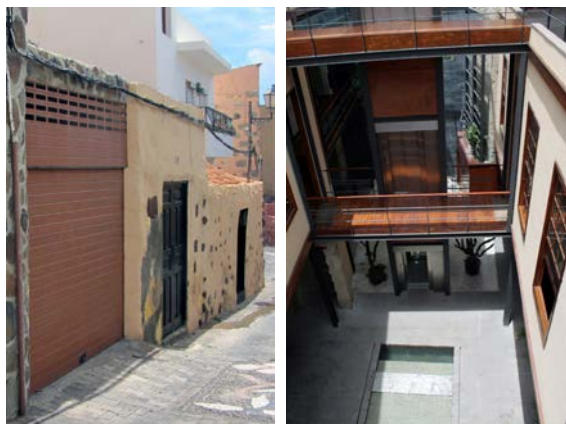
Fig. 8. Actuación en fachada para incorporar la puerta de un garaje. Ingenio (Canarias).Foto: Juan Carmelo Arjona Montesdeoca.
