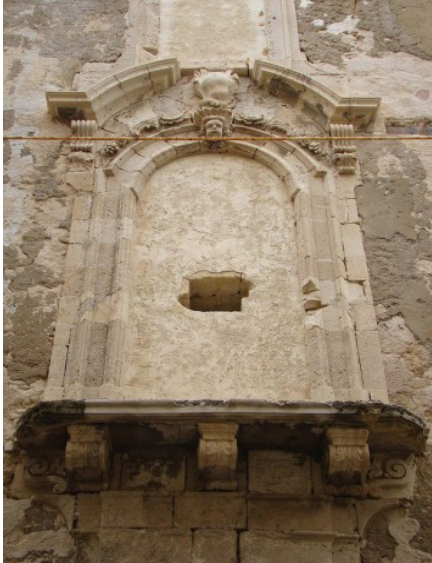
Fig. 8. Particolare del degrado del prospetto. Foto: Antonio Macchetti (dal sito www.antoniorandazzo.it )
