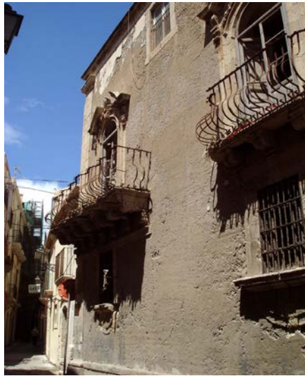
Fig. 7. Ammadoramento dell'intonaco con perdita degli strati superficiali. Foto: (G.D.O.) ( https://upload.wikimedia.org/wikipedia/commons/a/a2/2657_-_Siracusa_-_Palazzo_Bongiovanni_-_Foto_Giovanni_Dall'Orto%2C_22-May-2008.jpg )
