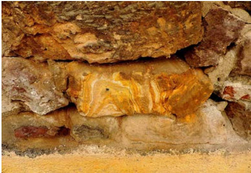
Fig. 4. Deterioro de Ignimbrita en inmueble de Morelia, Mich. Fuente Aldo Zamudio Pérez, 2017.
