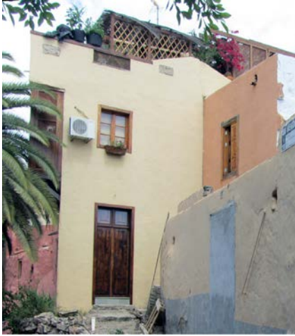
Fig. 10. Añadido en fachada que produce impacto visual y desvirtúa la composición original de la vivienda. Ingenio (Canarias). Foto: Juan Carmelo Arjona Montesdeoca.
