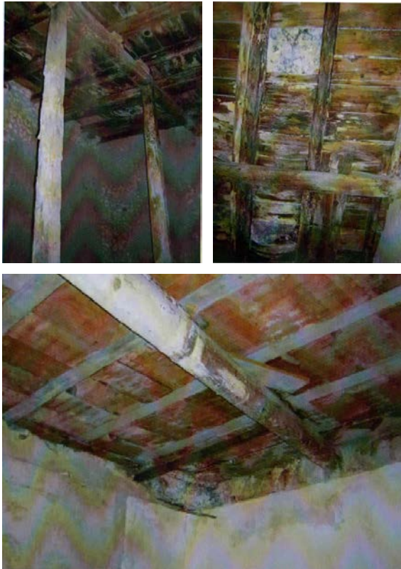
Fig. 10. Puntelli su solaio fatiscente costituito da putrelle in ferro e travi in legno. Foto allegata al progetto di restauro redatto dagli architetti Emanuele Giliberti e Antonio Merendino
