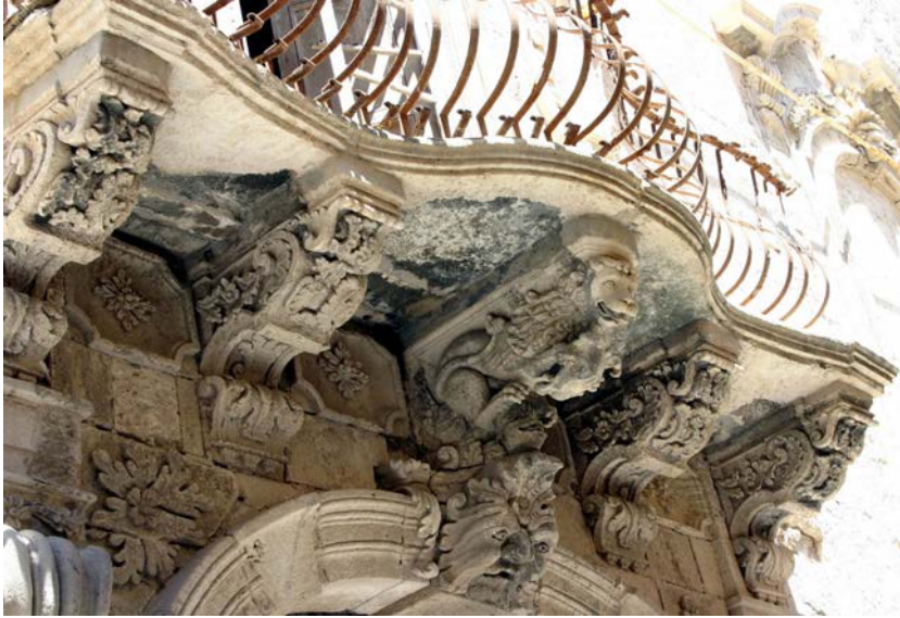
Fig. 6. Patine nere da solfatazione nelle sculture del balcone centrale. Foto: (G.D.O.) dal sito https://it.wikipedia.org/wiki/File:2664_-_Siracusa_-_Palazzo_Bongiovanni_-_Foto_Giovanni_Dall'Orto,_21-May-2008.jpg
