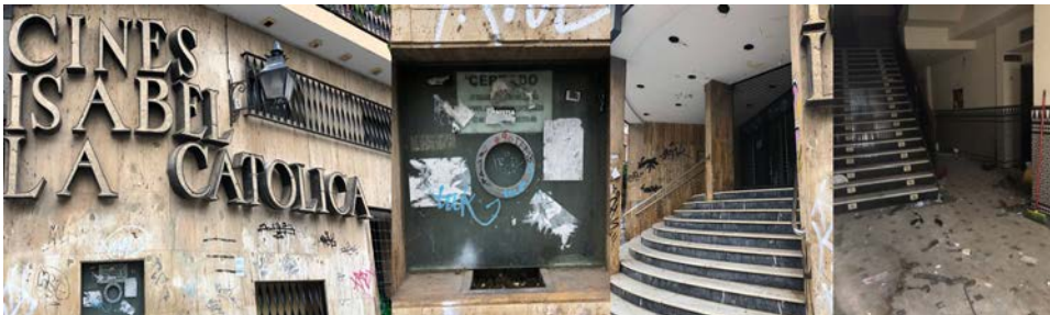
Fig. 14. Muestra de los daños antrópicos en Cine Isabel la Católica. Fotografías de los autores.
